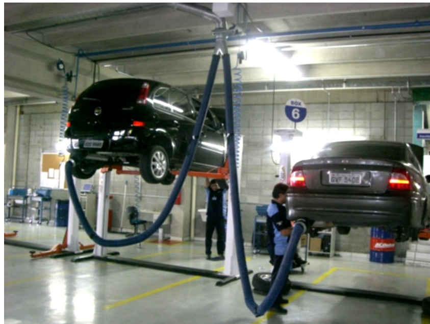
EXTRATOR DUPLO ATENDENDO A DOIS PONTOS DE EXAUSTÃO SIMULTANEAMENTE
