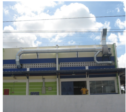
EXAUSTOR CENTRÍFUGO E TUBULAÇÃO NA ÁREA EXTERNA
